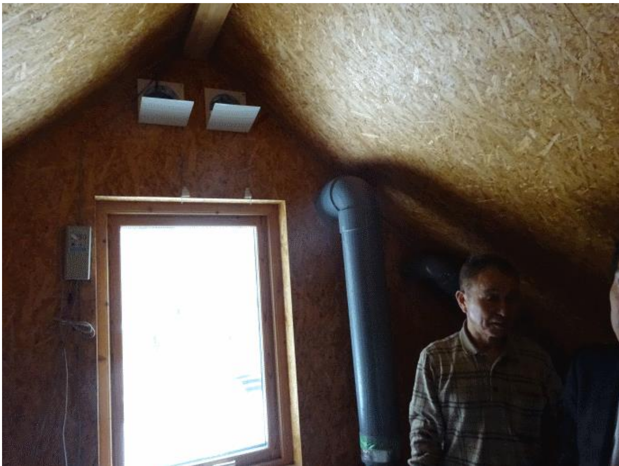
- гендиректор компании «Гудмин» г. Сайто объясняет принцип работы приточно-вытяжной вентиляции в частном доме.
